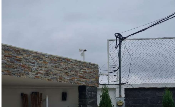
Vista de cámara de circuito cerrado de Tv.
